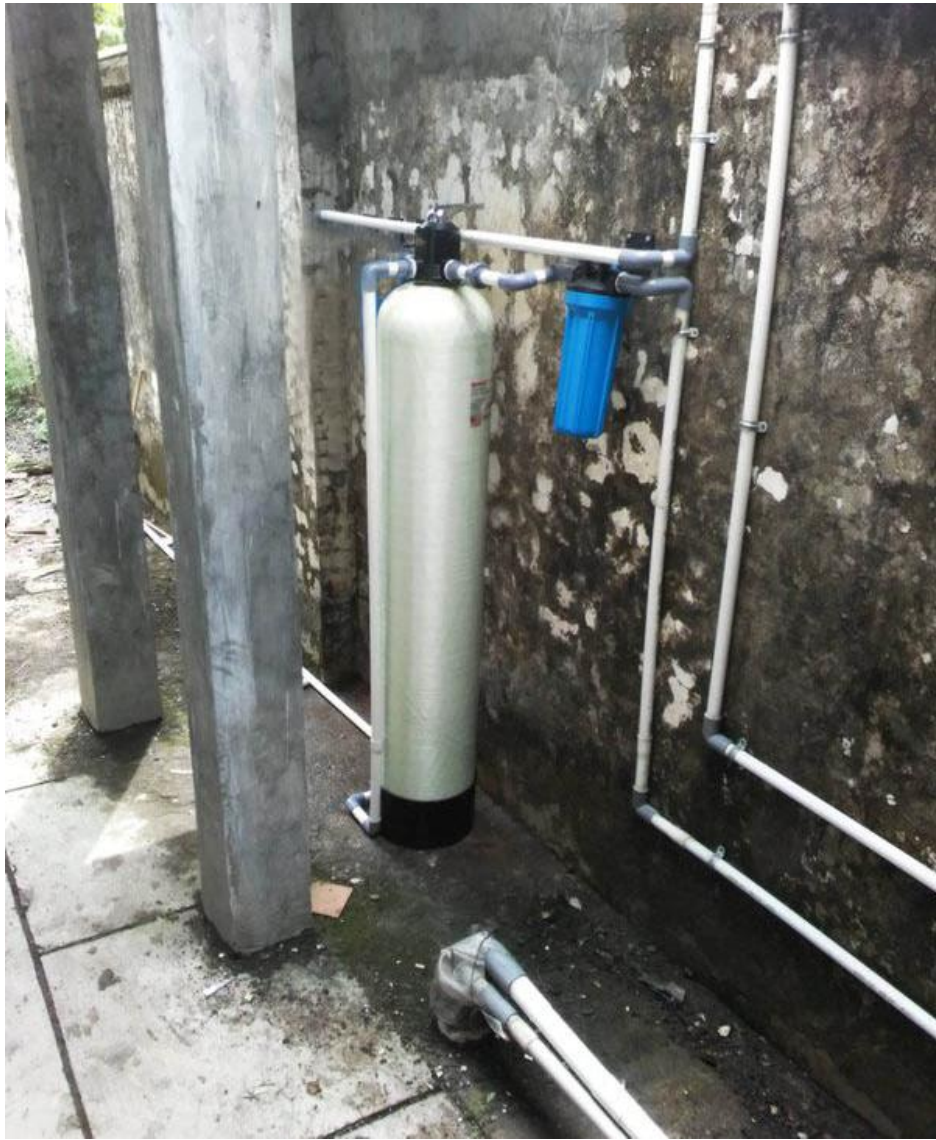
Gambar : Contoh Unit Paket Filter WTP ( Water Treatment Plant ) Penjernih Air Untuk Ternak Ayam (Agar Air Menjadi Sehat & Higienis) yang sudah terpasang dilokasi.
